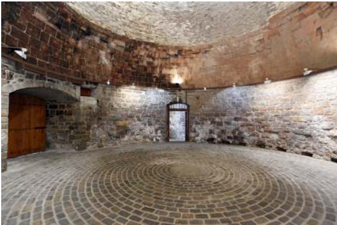
FOTO 11. VISTA GENERAL. ILUMINACIÓN
